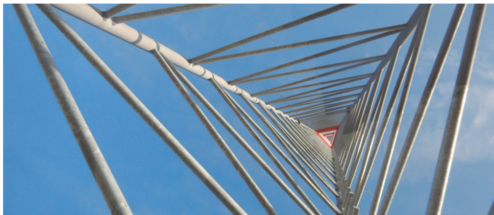
Höchster frei stehender Windmessmast in Norddeutschland
