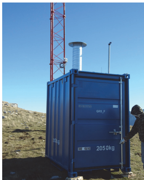
Power:Container - Autarke Energieversorgung für entlegene Standorte
