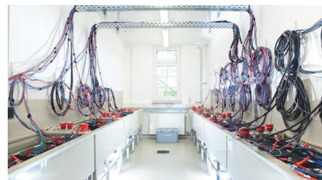
Wasserbäder Batterieprüflabor am Standort Pöhlde
